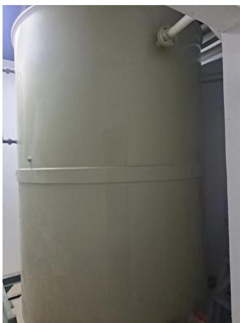
图 2-1 事故应急罐照片
