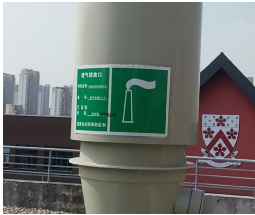
1#排气筒标识牌
