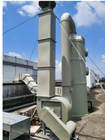
碱液喷淋装置 (FQ002)
