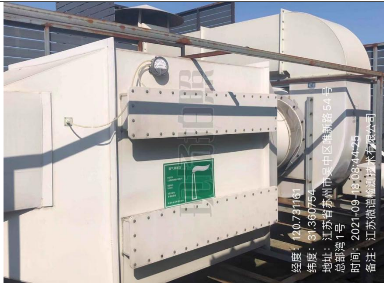
图 3-2 废气处理措施
